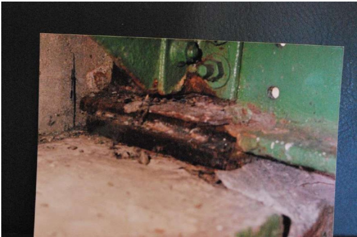
8 mm vastag oxidréteg a hossztartó alsó övének szélén, a mozgásképtelen, összerozsdásodott csúszólemez saru fölött. (Apci 2-3 nyílás, 1. hossztartó, 2. pillér)
