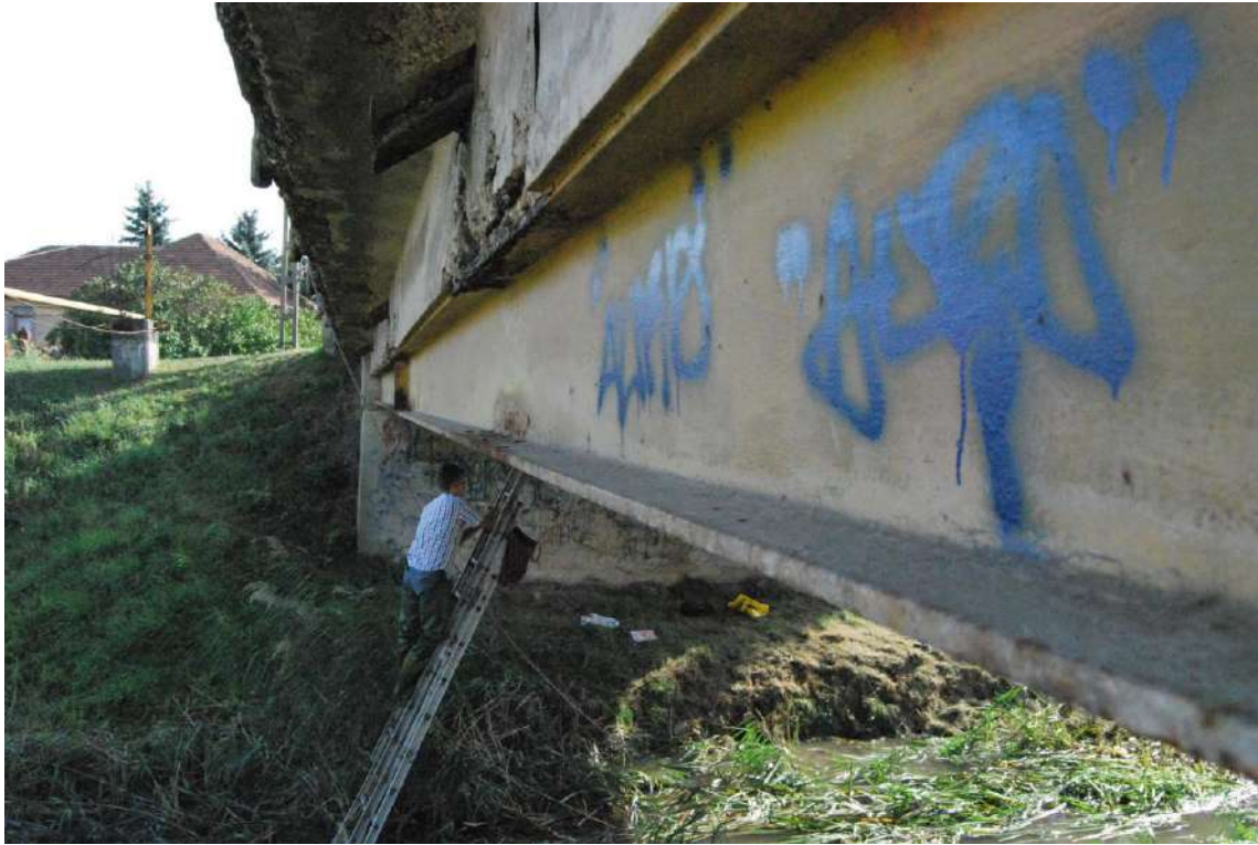
A 6. hossztartóban mért 9 mm maradó lehajlást már szemmel is lehet érzékelni. Látható, hogy az I-tartó felső övének jelentős korróziós károsodása a víznyelők alatti szakaszra koncentrálódik. Varratvizsgálat támasztólétrával (Tura, kifolyási oldal)
