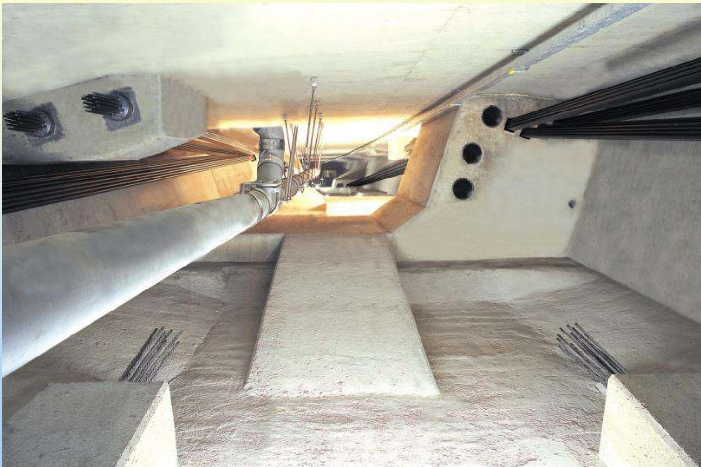
Flyover Münster: extern feszítőkábelek
