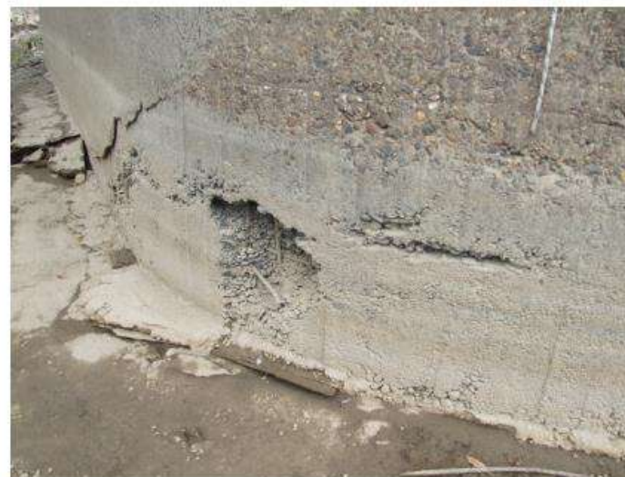
2008. augusztusában a mederpillérnél a lokális betonkimosódás láthatóvá vált Fotózta: Hajós Bence hídmérnök
